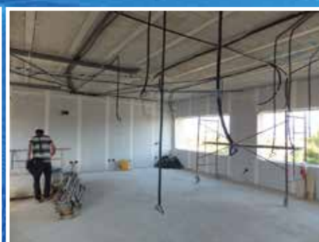
Mye rør og kabler må til
