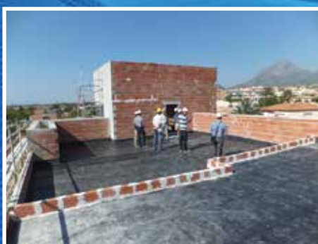
Takterrassen er sikret mot lekkasjer
